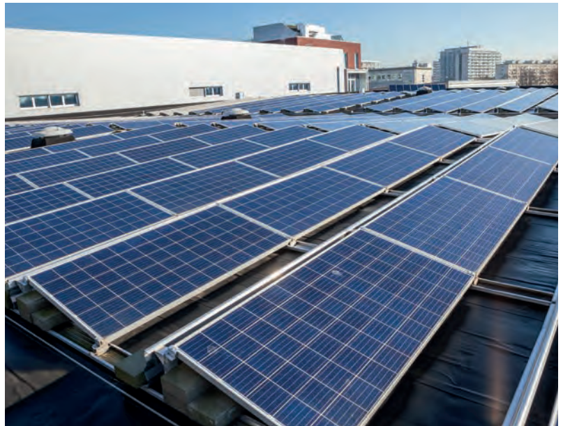
Ein Fotovoltaikpark könnte Harz Guss Zorge genug Strom für den Wechsel zum Induktionsofen liefern.
